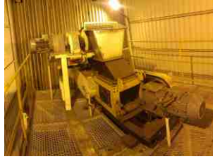
Kömür Numune Alma Tesisi
